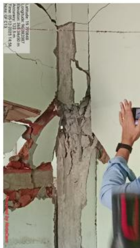
GF - C13 (Severe)
