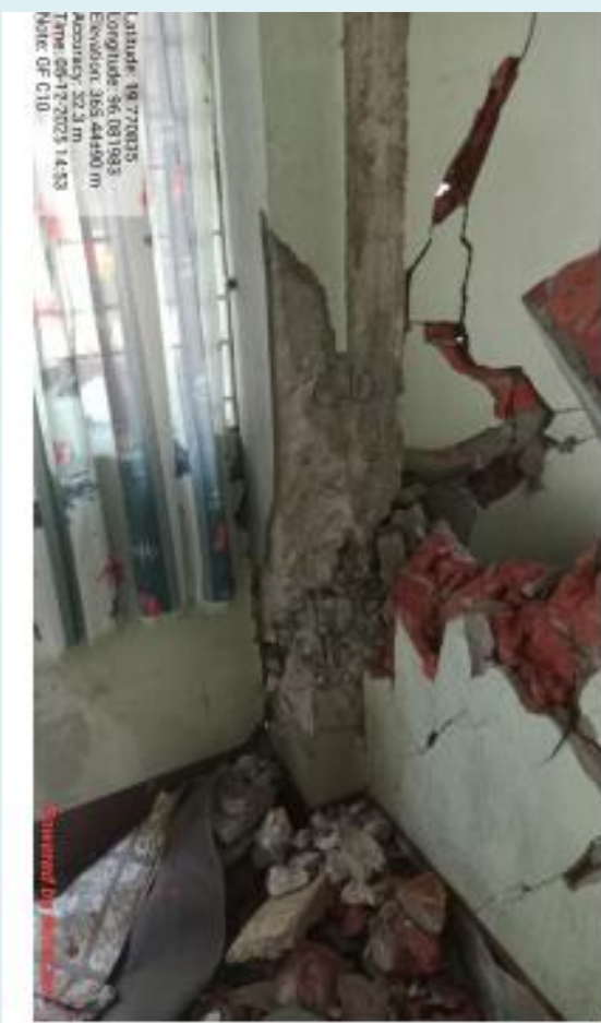
GF - C10 (Severe)
